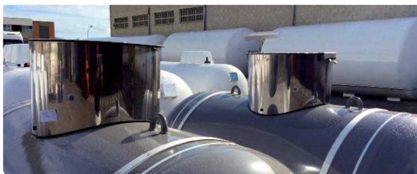
ARQUETAS DEPÓSITOS ENTERRADOS
