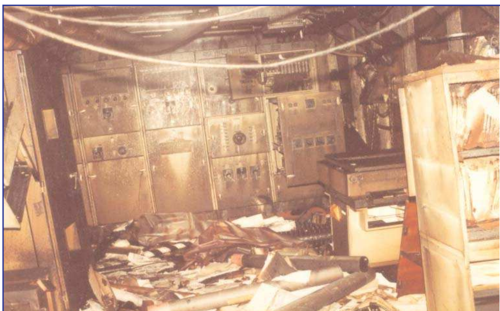
La Salle de transmission
