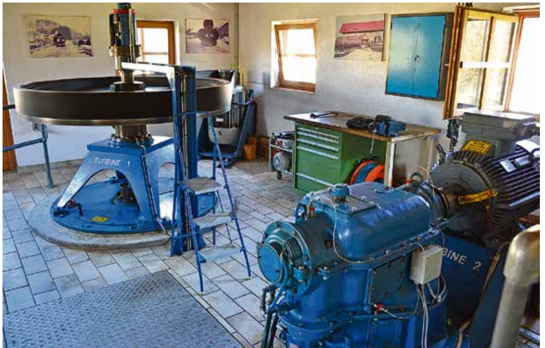
Der Maschinenraum im Kleinwasserkraftwerk.
