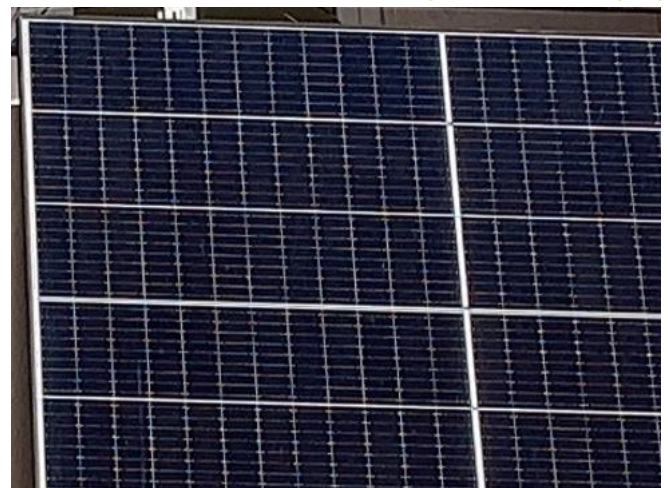
Solarpanele für eigene Stromversorgung
