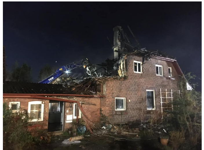
Das sanierte Bauernhaus wurde durch den Dachstuhlbrand völlig zerstört.
