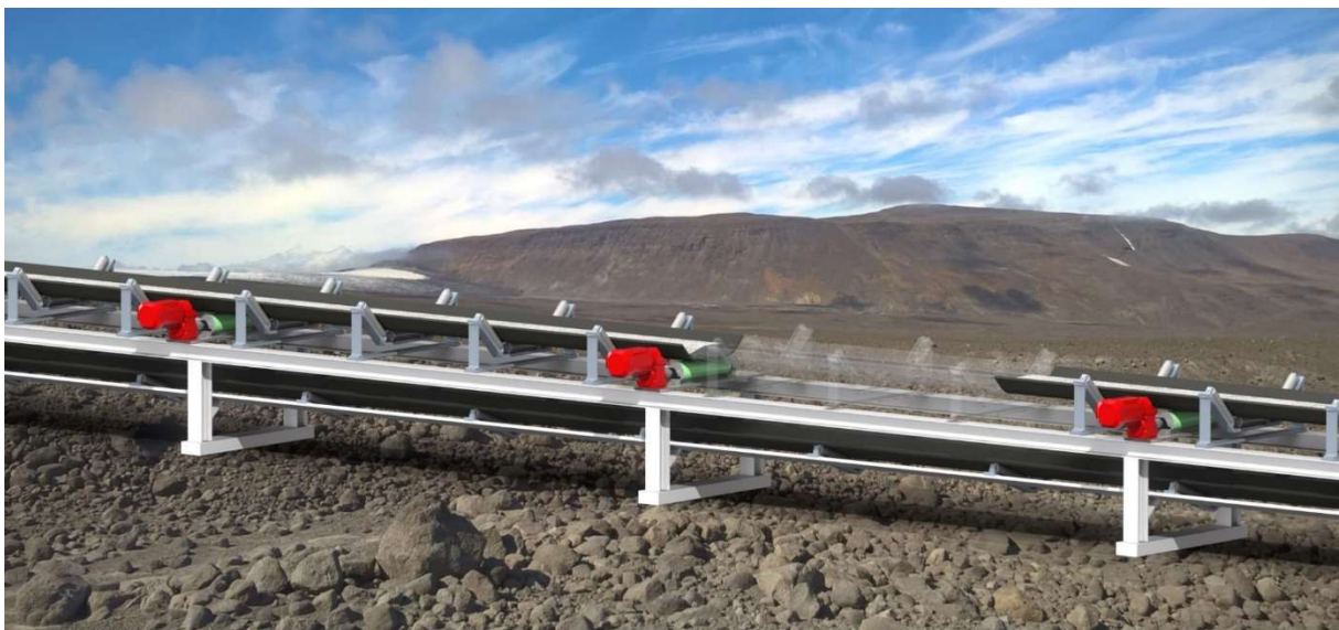
Abbildung 1: Förderanlage mit antreibenden Tragrollen
