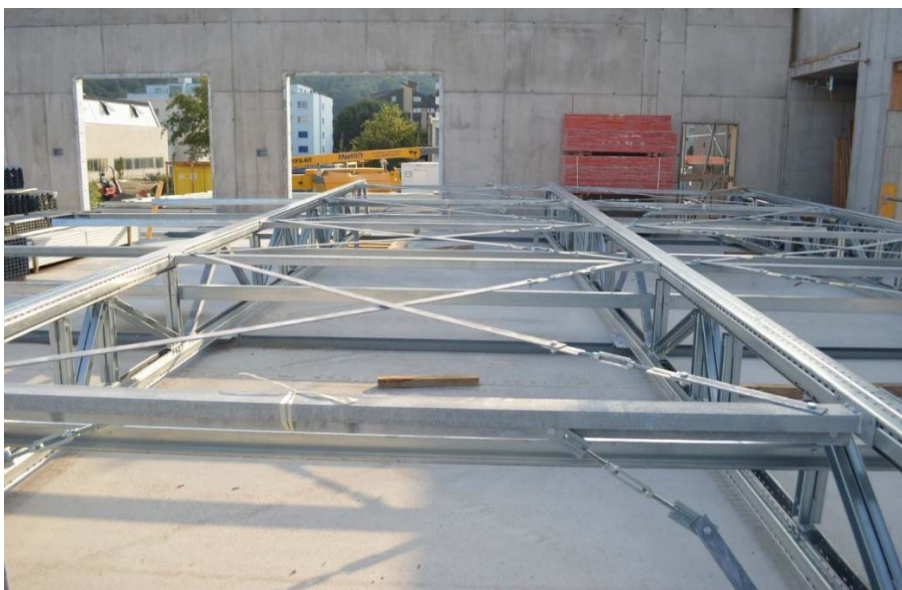
Abbildung 21: Montagezustand eines Regalmoduls aus Stahl mit Blick auf die Auskreuzungsverbindungen der Längsaussteifung, Quelle: Merz Kley & Partner ZT GmbH
