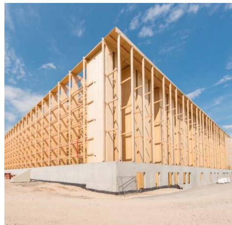
Abbildung 23: Aussteifungstürme mit anschließender Regalkonstruktion am Hochregallager der (Quelle:) Alnatura GmbH
