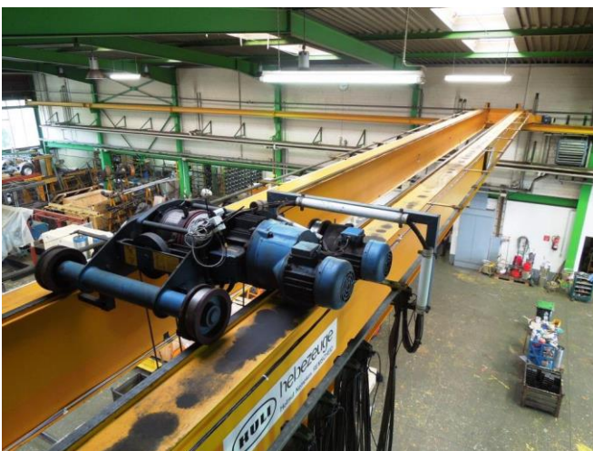
Abbildung 22: Messobjekt Zweiträgerkran ZK 3.2 t * 18,95 m
