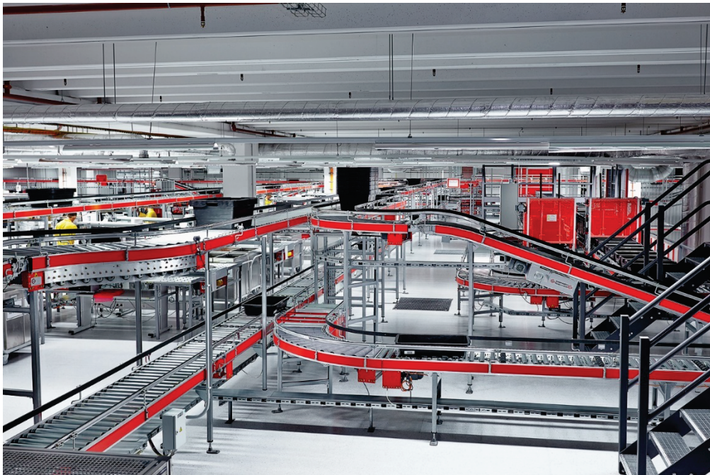
Abbildung 1-1: Beispiel für automatisierte Förderanlage in der Intralogistik (Bild: GEBHARDT Fördertechnik GmbH)
