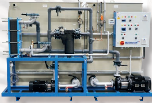
Pumpentechnologie mit Filtereinheit, Steuerung und Plattenwärmetauscher
