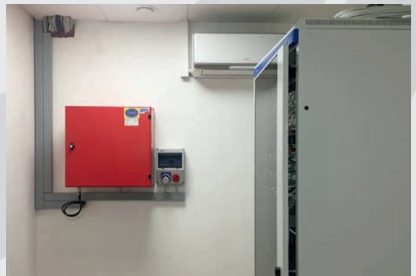
EuroBOS DAU mit externer Notstrom-Einspeisung.
