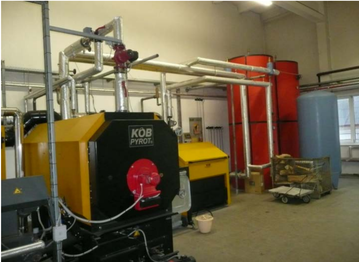
OHSI-Projekt Fernwärme-Heizwerk 330 kW Wolma/Minsk für Holzbrennstoffe (2008)
