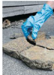
Bei dieser Tonfliese hat sich der Kleber gelöst.
