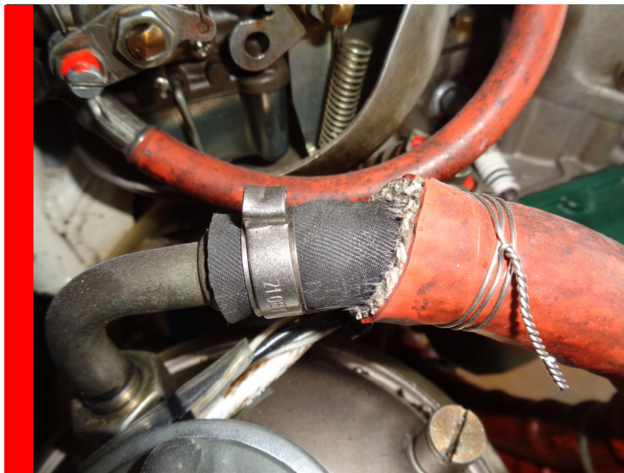
Feuerschutzschlauch zu kurz / Fire protection hose too short
