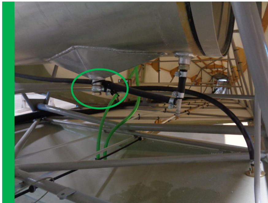
Kraftstoffleitung zum Drainer richtig angeschlossen / Fuel line to the drainer connected correctly
