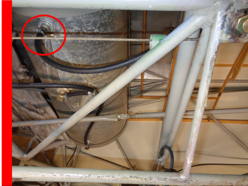
Kraftstoffleitung zum Drainer falsch angeschlossen / Fuel line to the drainer connected incorrectly
