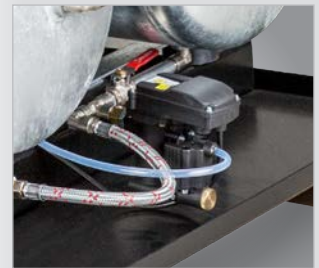
· Automatischer Kondensatableiter am Behälter
