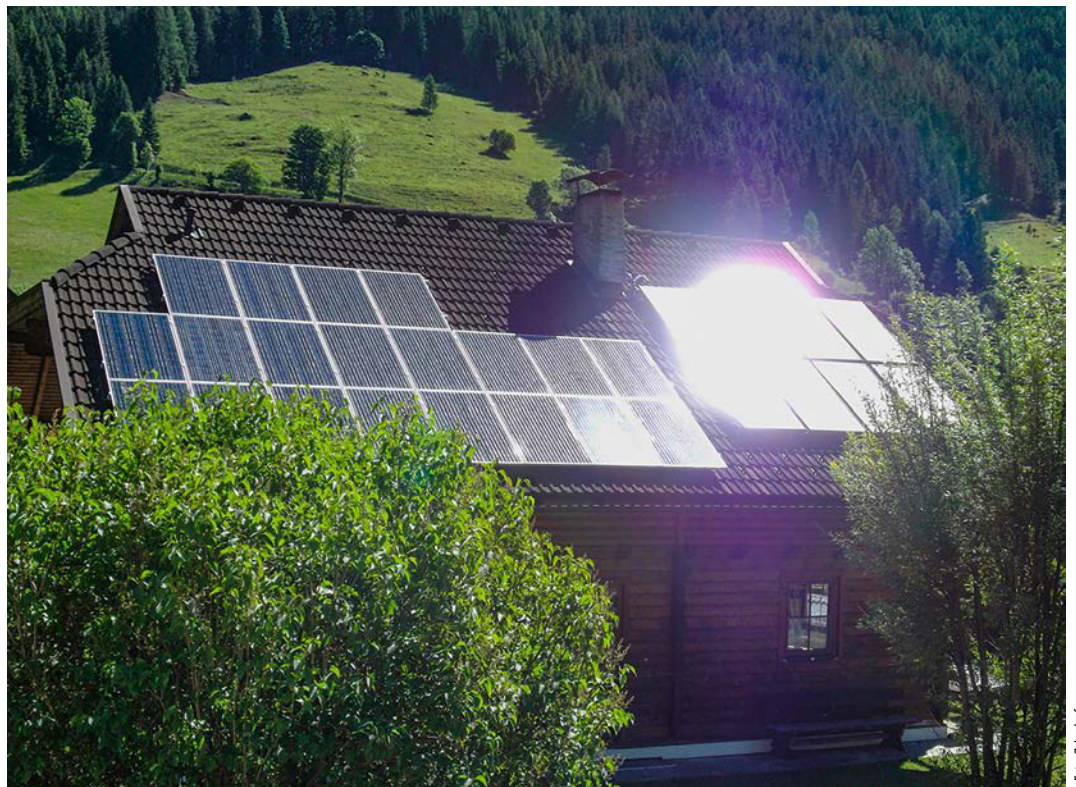
Blendung durch Solarmodule muss der Nachbar unter Umständen hinnehmen.
