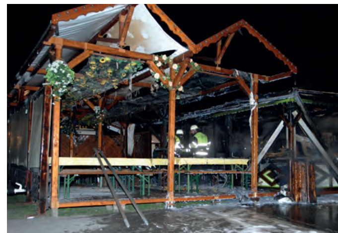
Abb. 36: Durch Brand zerstörter Gastronomiebetrieb
