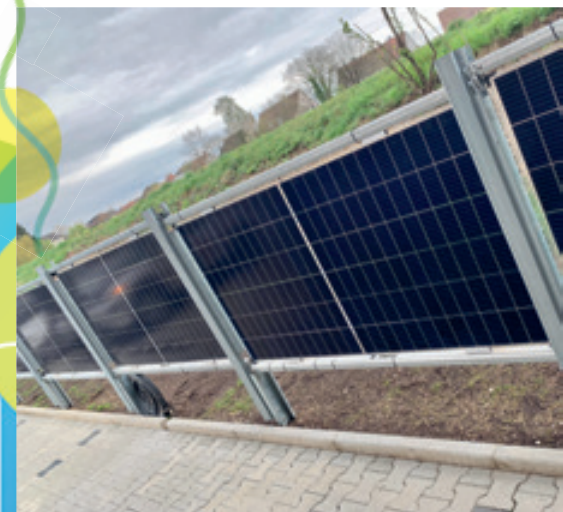
Klimapositiv. Solarzellen von Dach, Zaun und Fassade sowie zwei Windräder produzieren über 80 Kilowatt Energie.
