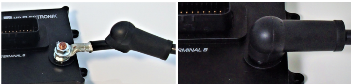
Figure 2.5: Batterieanschluss mit Schutzkappe
