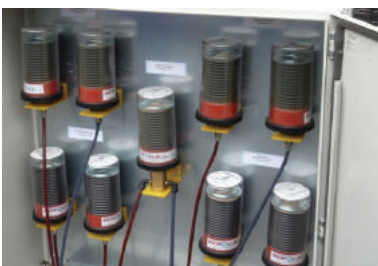
Verarbeitung von Lebensmittelabfällen: Schrank mit mehreren MEMOLUB-Einheiten für die Schmierung der Lager und des Gehäuses eines Rotationsfermenters.
