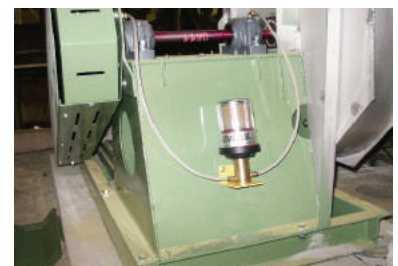
Nahrungsmittelindustrie: Schmierung von Solyvent Ventec Ventilatorlagern.
