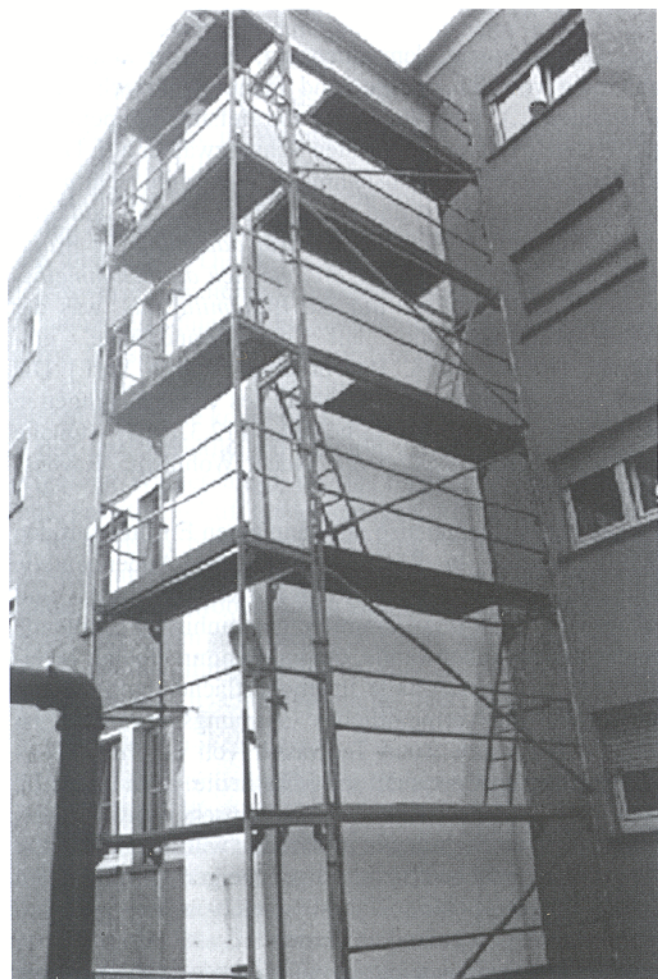
Bild 6. Außeneckendämmung gegen Schimmelbefall in Konstanz.
