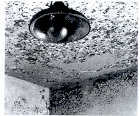
Bild 4. 1958: Schimmelbildung unter einer ungedämmten Betondecke – trotz undichter Fensterfugen.
