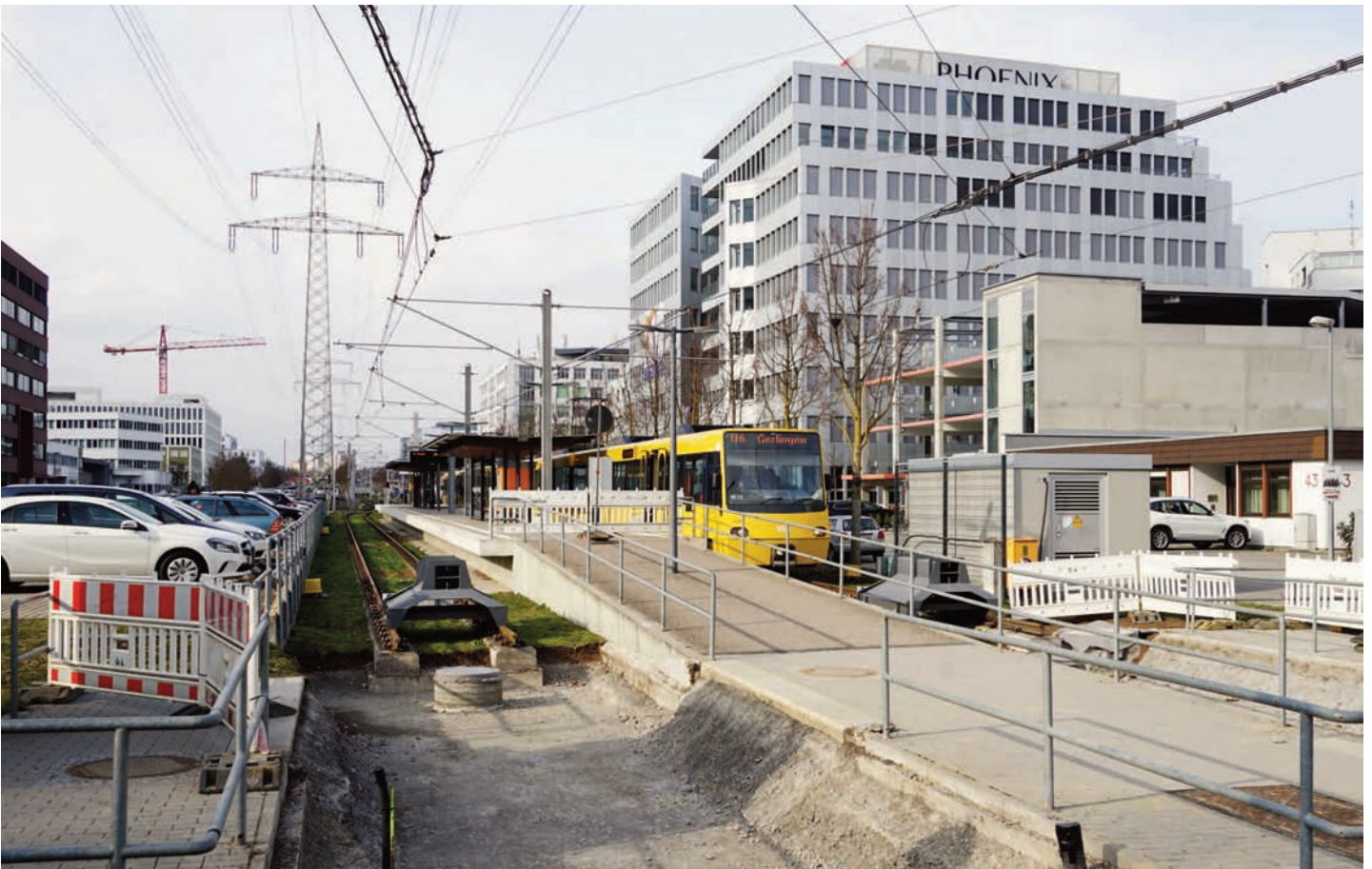
SSB-km 2,770: Bauanfangspunkt an der derzeitigen U6-Endhaltestelle Fasanenhof Schelmenwasen, hier der Blick Richtung Norden. Vor dieser Haltestelle gibt es einen doppelten Gleiswechsel.
