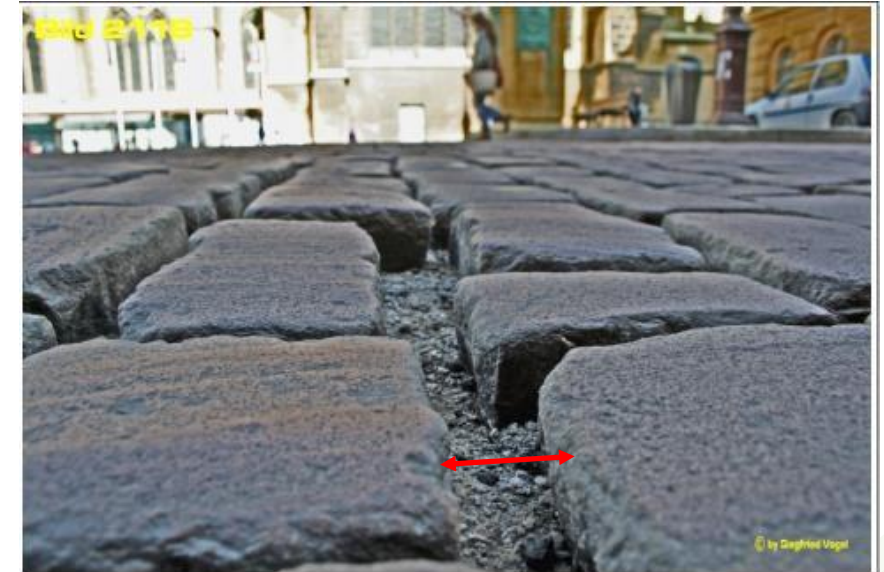
Schadens Dokumentation Siegfried Vogel: Sowas entsteht u.a durch gebildete Fugen im Pflastervorgang.
