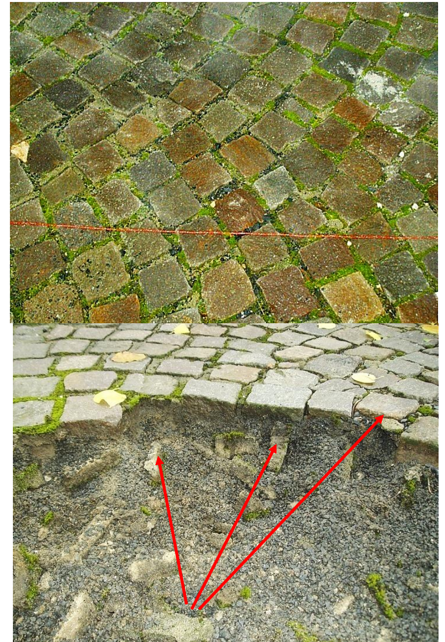
Abb. 92 und 93 gut zu erkennen die verfaulten Reste der Epoxid-Verbindung .
